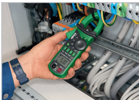
在开关柜中进行电流测量
